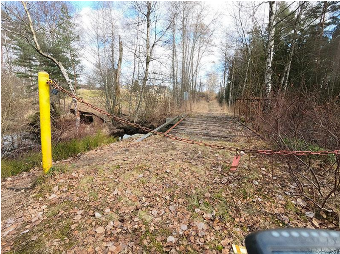
Fallfärdig bro där passage avrådes. Notera även underlaget för den vidare färden.
