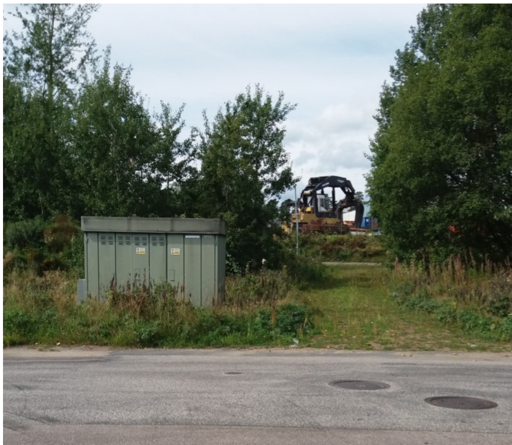
Transformatorstationen och naturområdet med nedgrävda ledningar.
