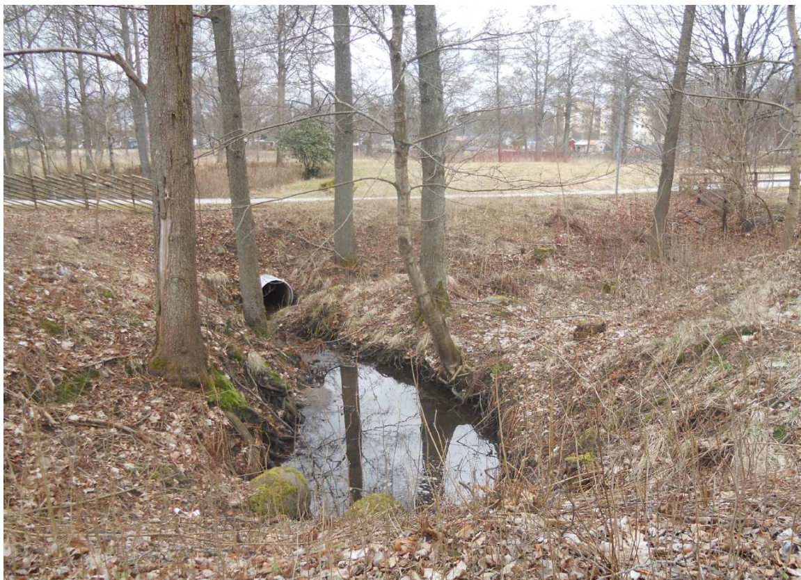
Dagvattenanläggningen vid Replösavägen.
